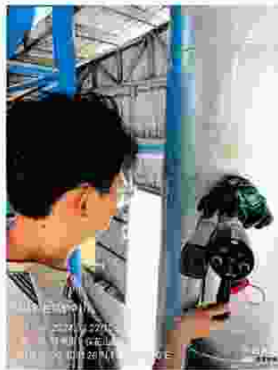
P1 DA001 排气筒出口
